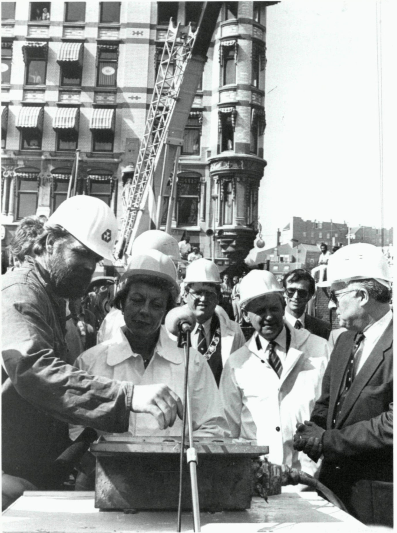
12. Minister mevr. drs. N. Smit-Kroes ontvangt instructies voor het in werking stellen van de heimachine waarmee het eerste stuk damwand voor de Spoortunnel Rotterdam wordt geslagen; 28 april.
