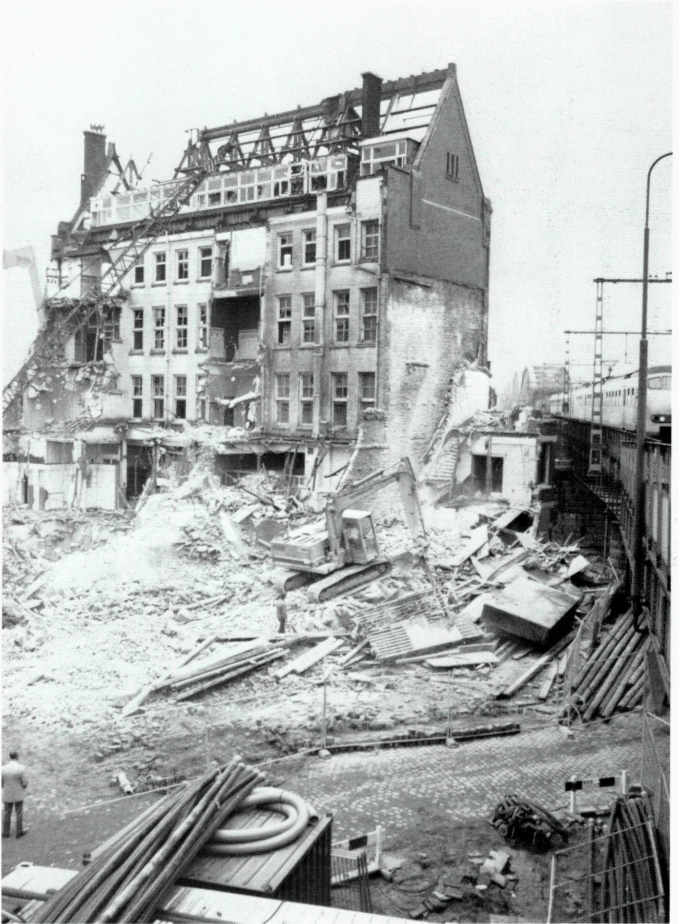
40. Sloop van het laatste gebouw aan de Wijnhaven, het 'Hudigpand' (nr. 23-25); opname 30-11-1987, uit het noordwesten.
